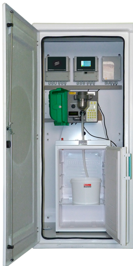
Stacja z urządzeniami pomiarowymi
